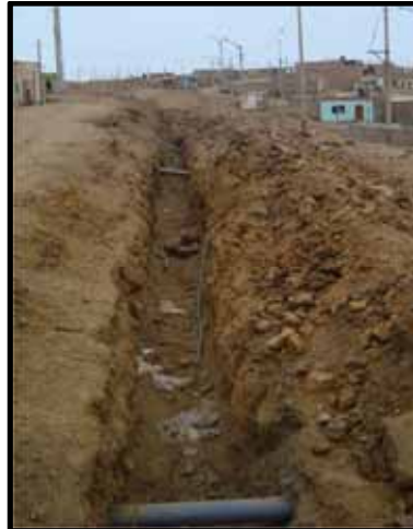
Foto N°3: Vista de excavación de zanja en terreno rocoso por la AA.VV Manzanares, con profundidades menores de 0.80m.
